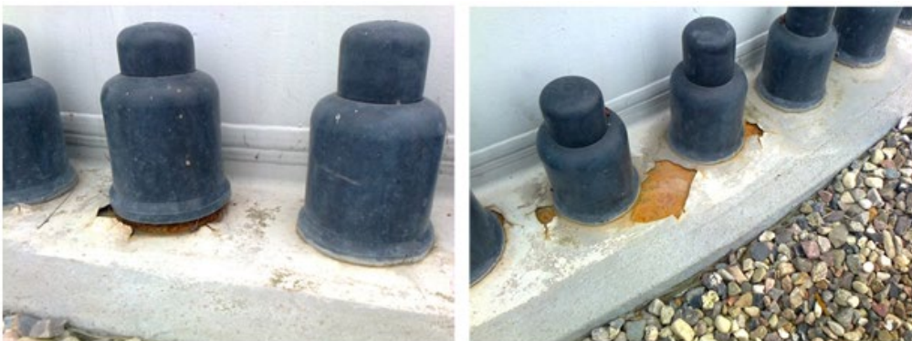
Abbildung 14: Korrosionsprobleme im Flanschbereich bei Vollwandmasten
