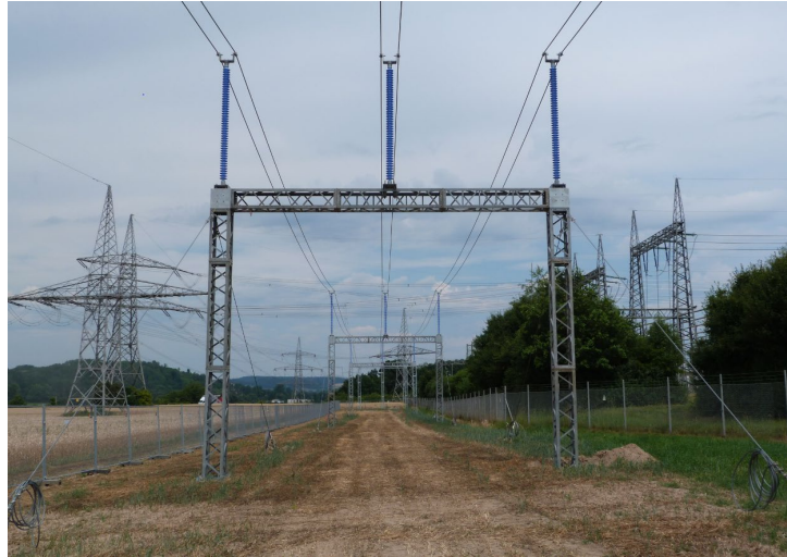
Abbildung 26: Freileitungsprovisorium für ein System mit Abankerung
