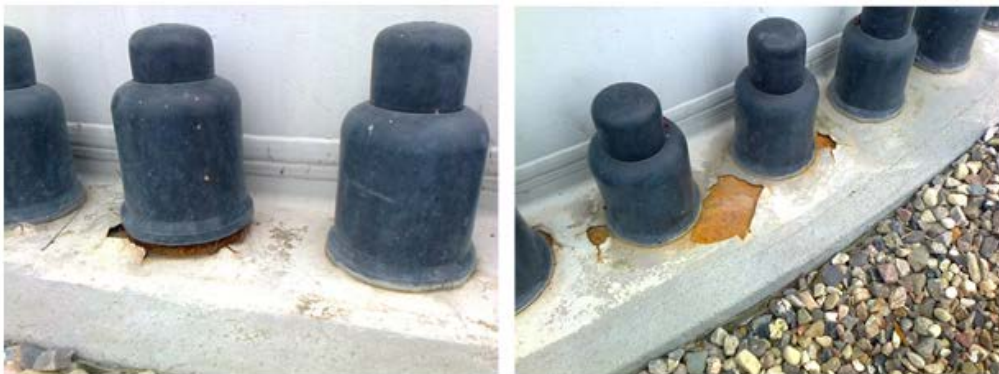
Abbildung 12: Korrosionsprobleme im Flanschbereich bei Vollwandmasten
